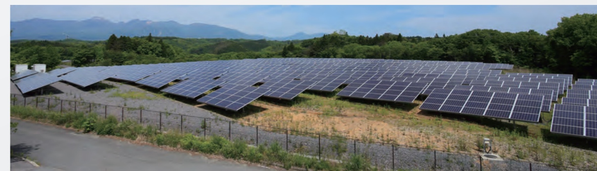
那須ちふりメガソーラー（栃木県那須郡）
