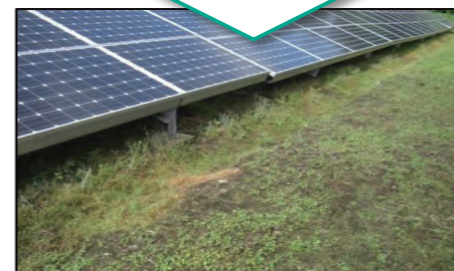
ヒツジが毎日草を食べてくれることで、パネルに草がかかることもなく発電効率の向上が見込まれる
